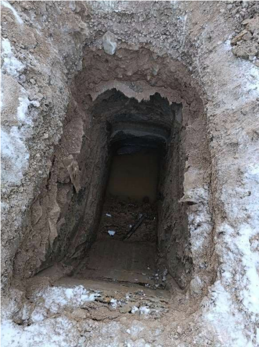
Kuva 1. Tutkimuspiste SW1. Tutkimuspisteessä havaittiin pohjalla kaapeli ja pohjalle suotautui hieman vettä.
