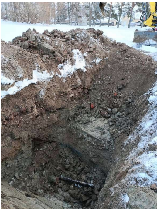
Kuva 4. Tutkimuspiste SW4. Tutkimuspisteessä havaittiin jätteitä tiiltä ja betonia. Jätettä esiintyi pintakerroksessa metrin paksuudelta.
